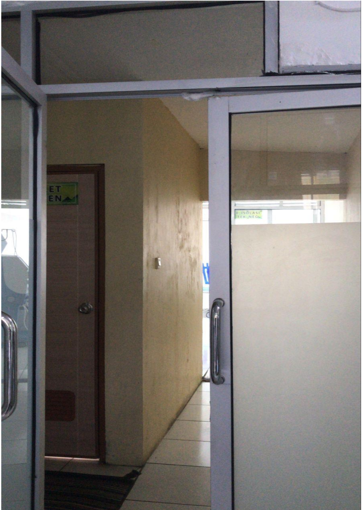
PINTU R.HD RUSAK
