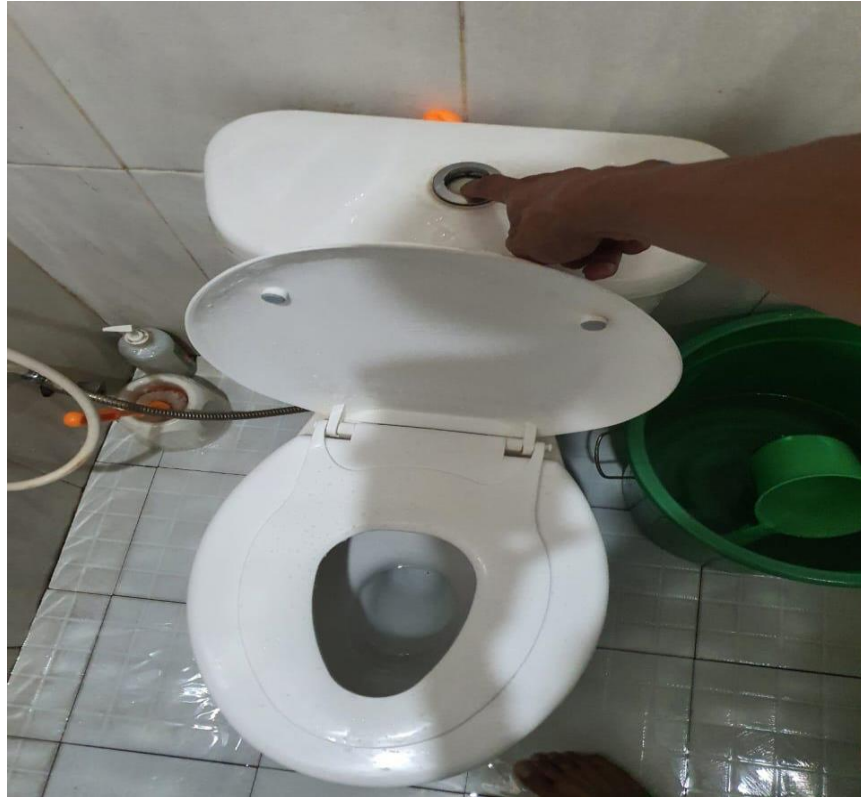
TOILET MASJID TOMBOLNYA TIDAK BERFUNGSI
