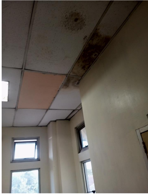
PLAFON RUSAK RUANG TERATAI
