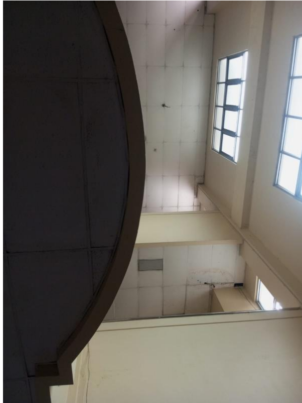
ATAP RUSAK DI POLI UMUM
